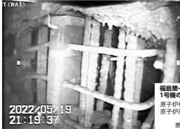
本来はコンクリートで覆われているが、鉄筋がむき出しになった原子炉の土台。鉄筋の上に燃料デブリの可能性のある堆積物がある＝国際廃炉研究開発機構、日立GEニュークリア・エナジー提供
